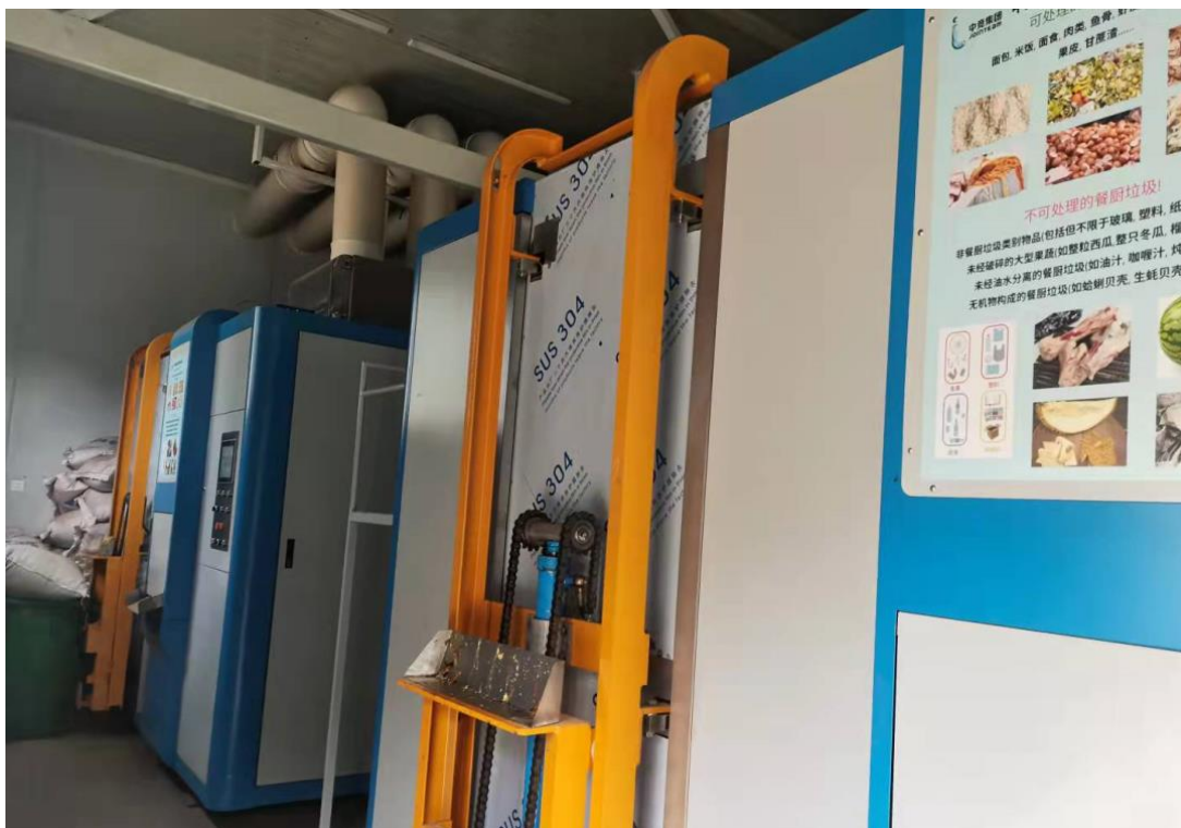
图5-3 团河校区厨余垃圾就地处理站内部（2台设备）
