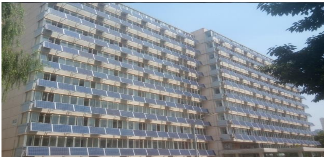
光伏发电设备
