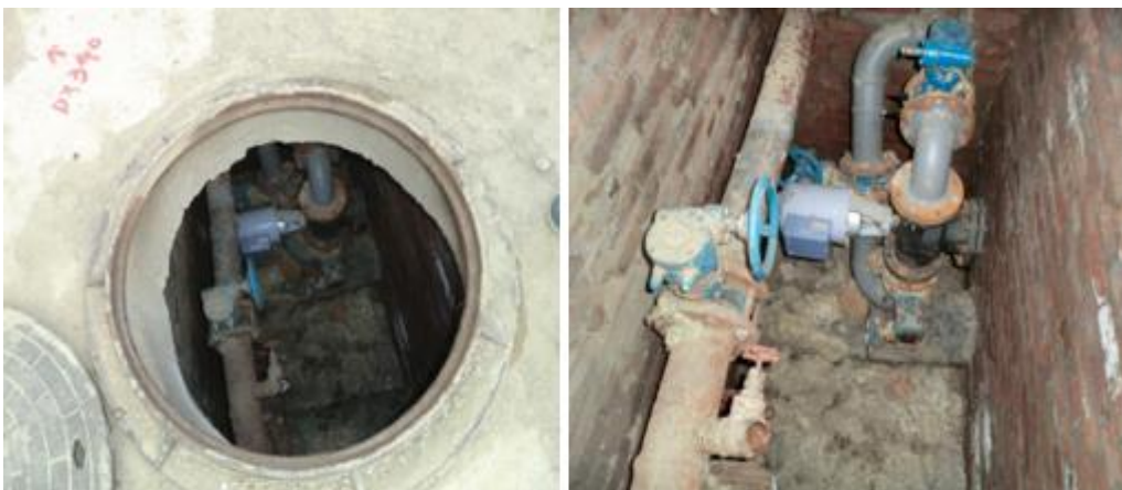
建筑进户安装的智能电动调节阀
