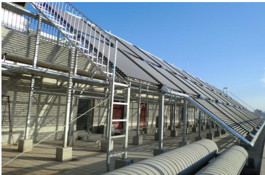
楼顶的太阳能集热器
