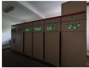
2 号公寓配电室
